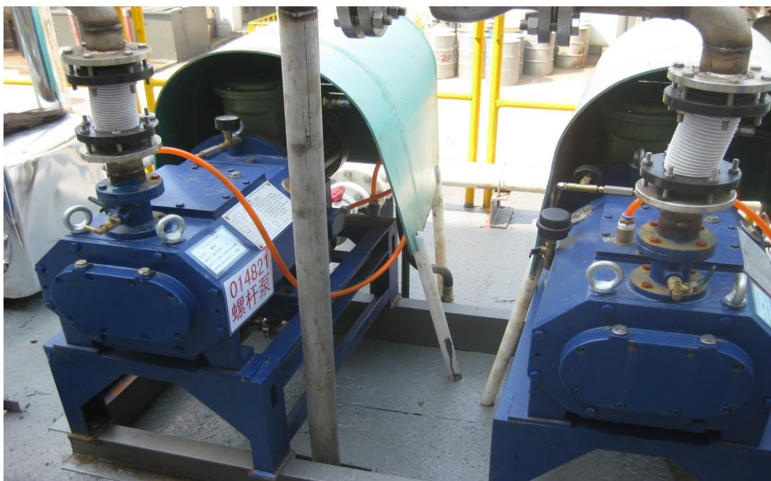
图6-2 企业甲醇回收采用的螺杆泵
